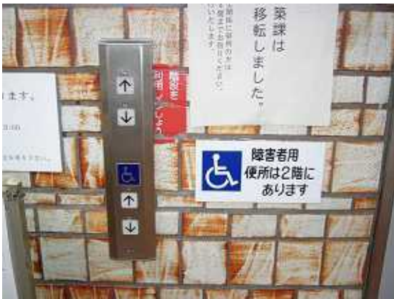
庁舎1階 エレベータースイッチ
